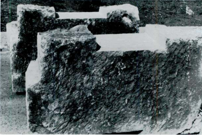
Res. 20 - Taktaki onarım alıřmalarından diđer bir grnm: ngerme kılıf borularının gemesi iin buyıl ekirdek bořaltma iřlemine tabi tutulan F-L sıralarına iliřkin tařlardan iki tanesi, sz konusu hazırlık iřleminden sonra.
