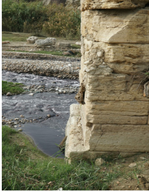
Resim 19: Asopos Köprüsü'nde geniş kemerin batısında üçüncü kemerin batı ayağının güney dibinde tahrip olan selyarana ait blok çıkıntısı ve Asopos Nehri'nin günümüzdeki yatağı.
