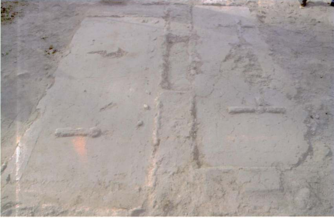
Resim 39- Döşeme harcındaki haç işaretleri, (Niksar Belediyesi Fotoğraf Arşivi).
